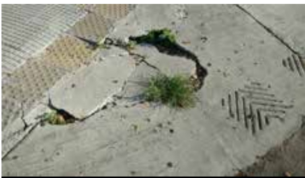
Rampa en mal estado.
